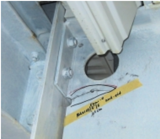
Figure C.2 Crack initiating from Cope (Courtesy Sedlacek, G., Dahl, W., Hoffmeister, B., Kuhn, B., Feldmann, M., Pinger, Th., Langenberg, P., Eichenmuller, H., Grotmann D., Blum, M. 'Zur Sicherer Anwendung feuerverzinkter Stahltrager', Stahlbau 73 (2004), Heft 6, Page 427-437, Ernst & Sohn Verlag, Berlin.)
